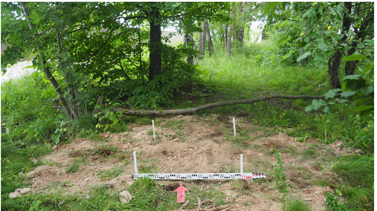
Рис. 82. Калужская область. Ферзиковский район. 2022 год. Археологическое обследование по трассе строительства канализации в п. Дугна. Шурф 5 после рекультивации. Вид с юга.
